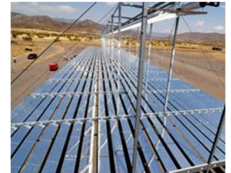
Centrale solaire à miroir de Fresnel Génération directe de vapeur
